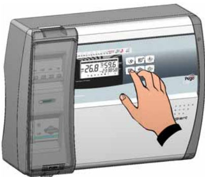
Fig. 17: Dare tensione di alimentazione al quadro ed effettuare una scrupolosa lettura/programmazione di tutti i parametri impostati
